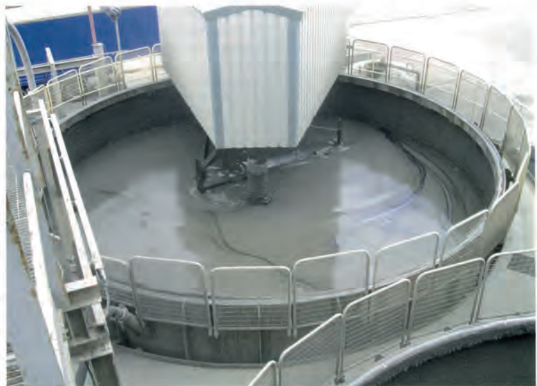
Für das optimale Mischungsverhältnis ist es bei der Porenbetonherstellung wichtig, die Bestandteile entsprechend der Produktrezepturen genau zu dosieren. Foto: proMtec Theisen GmbH
